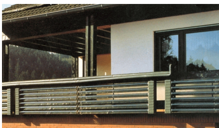
Fig. 3. Instalación de calefacción solar mediante captadores TubuSol de Viessmann.
